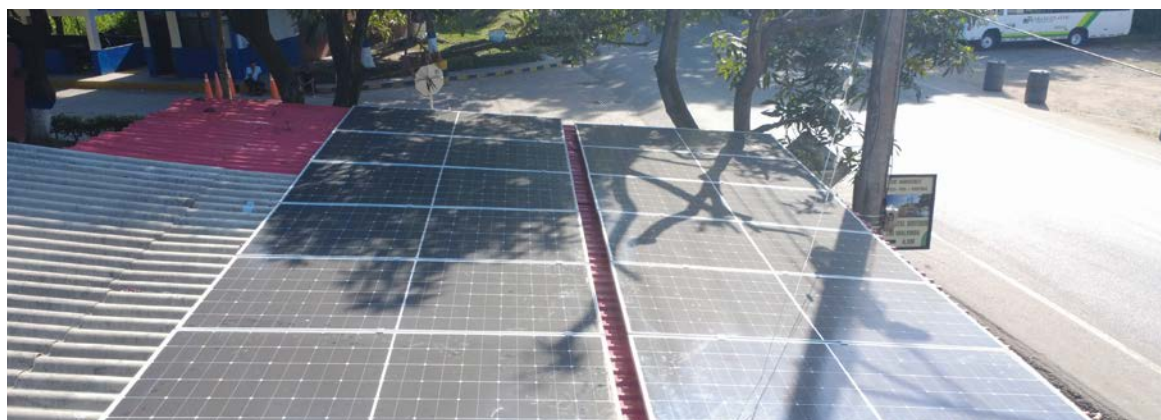
Figura 8. Fotografía aérea de la estación de carga compartida con un arreglo de paneles solares. Fuente: Polen TJ, piloto en La Guajira.
